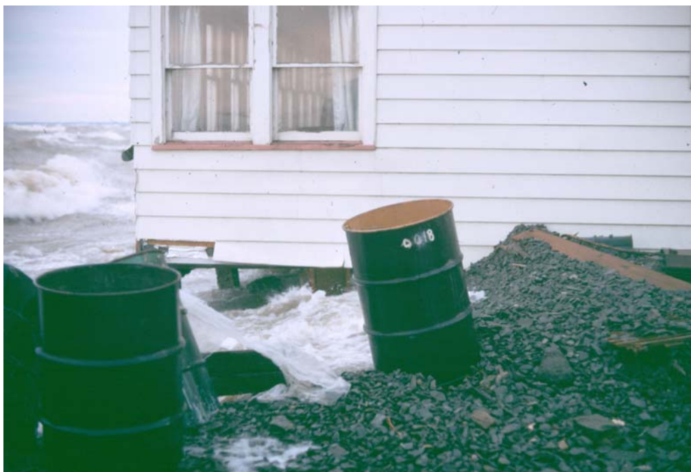
Exemple de dommages structurels occasionnés par les vagues aux fondations d'une maison
